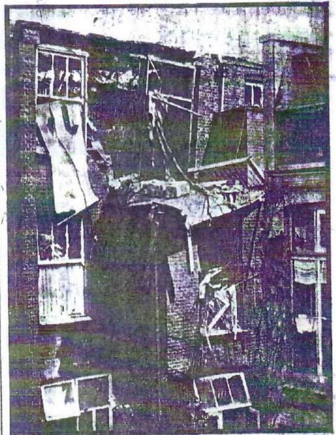
De zwaar beschadigde achtergevel van het pand aan de Valkenboschkade, dat door de bom werd getroffen.
